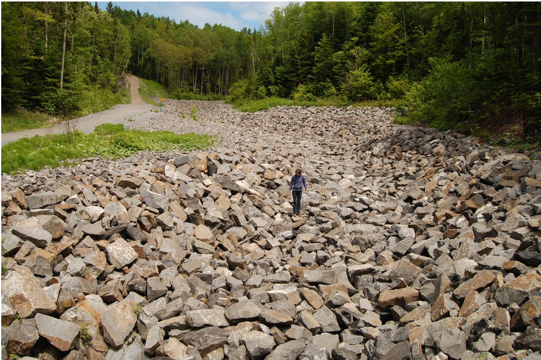
Stabilisation par enrochement massif sur 2.2 km du ruisseau Bonhomme-Morency en 2009 (photo en 2012) – coût: 3,2$millions
